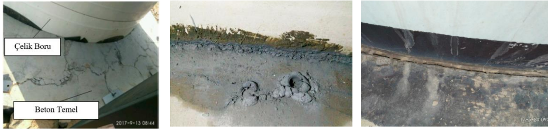
Şekil 14. (a) Yüzeysel Çatlaklar (b) Beton Geri Tepmesi (kusması) (c) Gömülü Halka Ve Beton Arasındaki Boşluklar [10]
