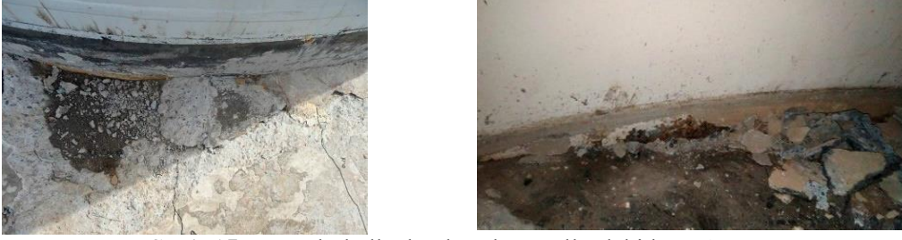
Şekil 15. Gömülü halka bağlantılı temellerdeki hasarlar [9]
